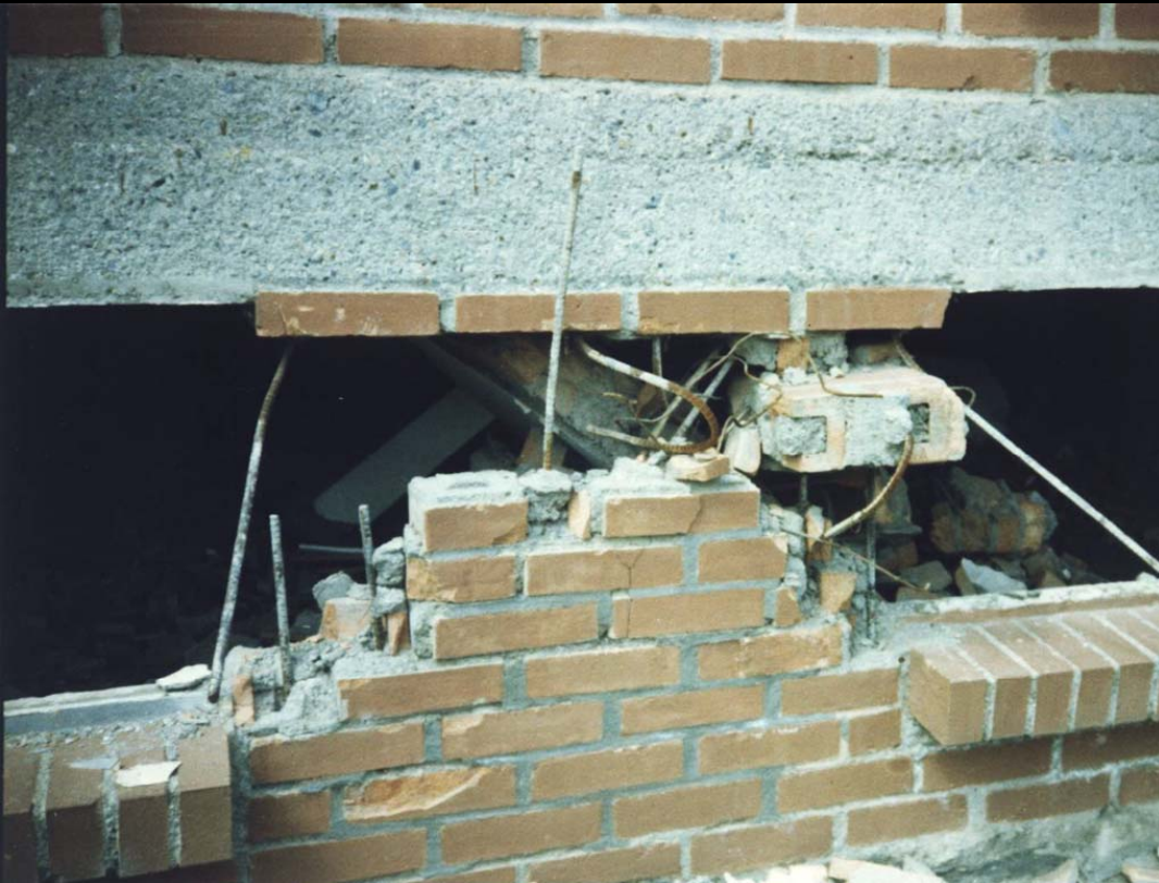
Falla por traslape del refuerzo vertical
