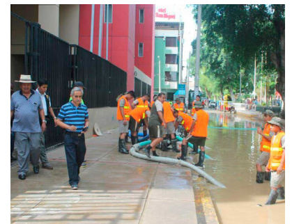
Filtración de agua en el Archivo de Piura
