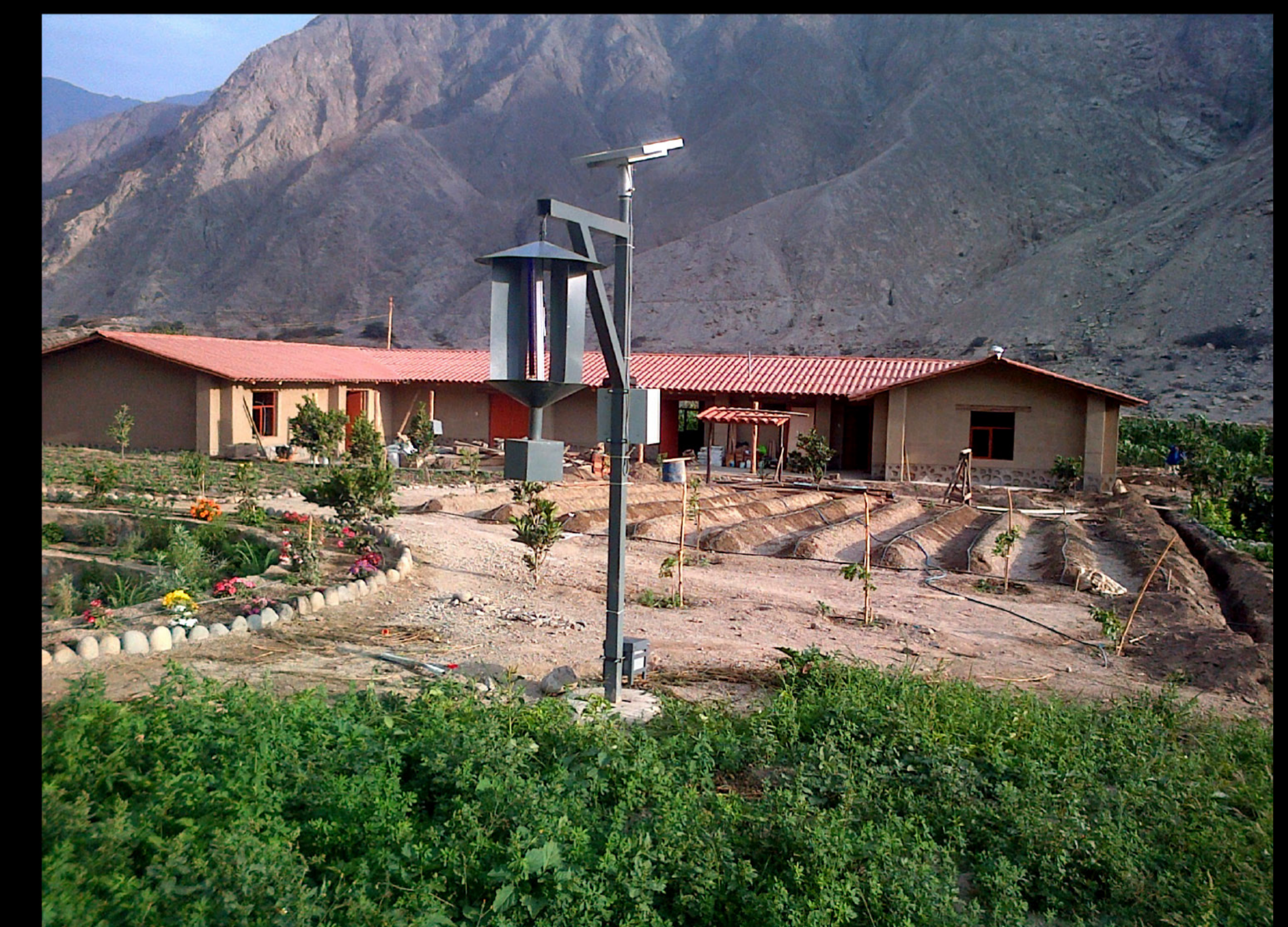
Sistema fotovoltaico de trampa solar.
