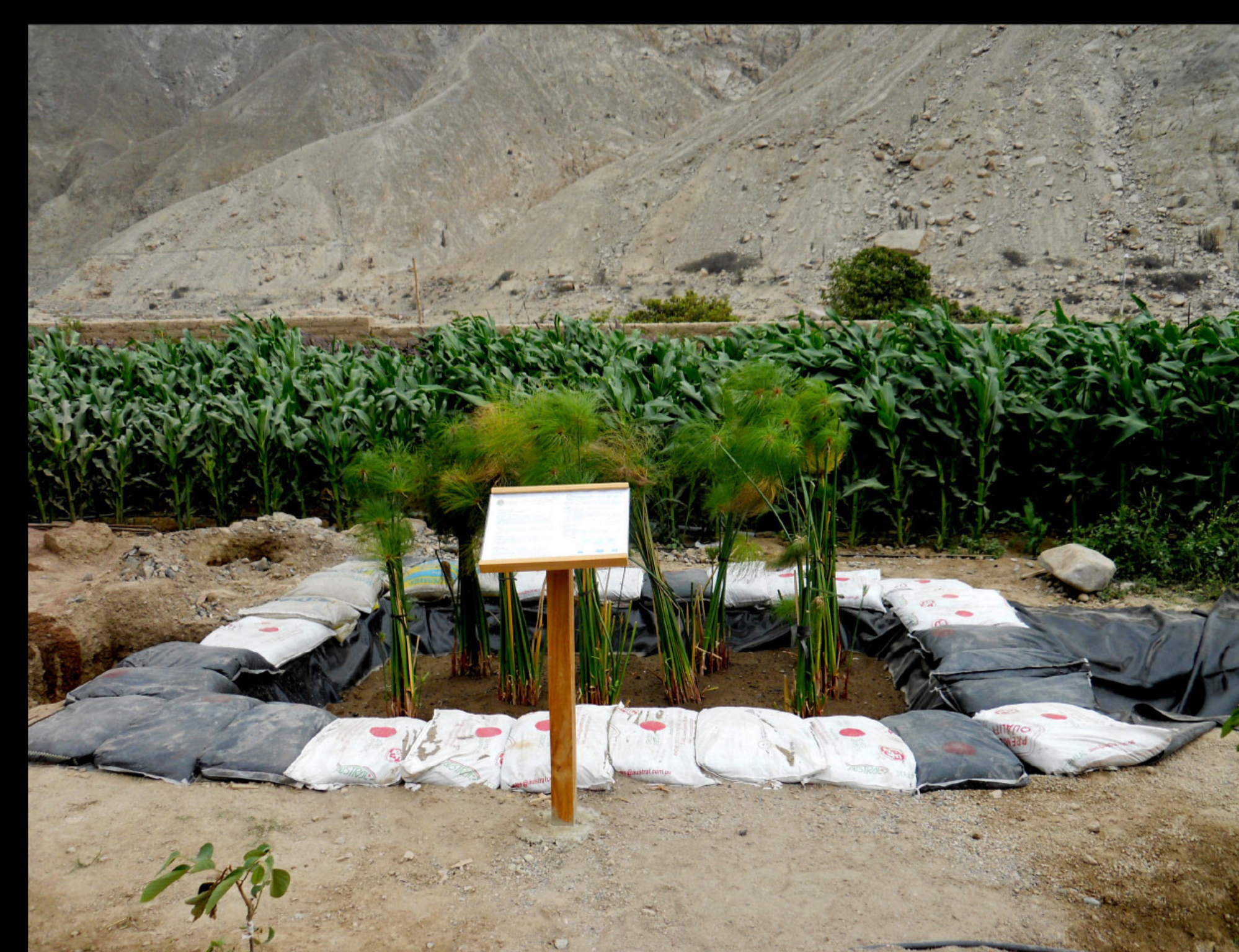
Planta de fitotratamiento de agua.
