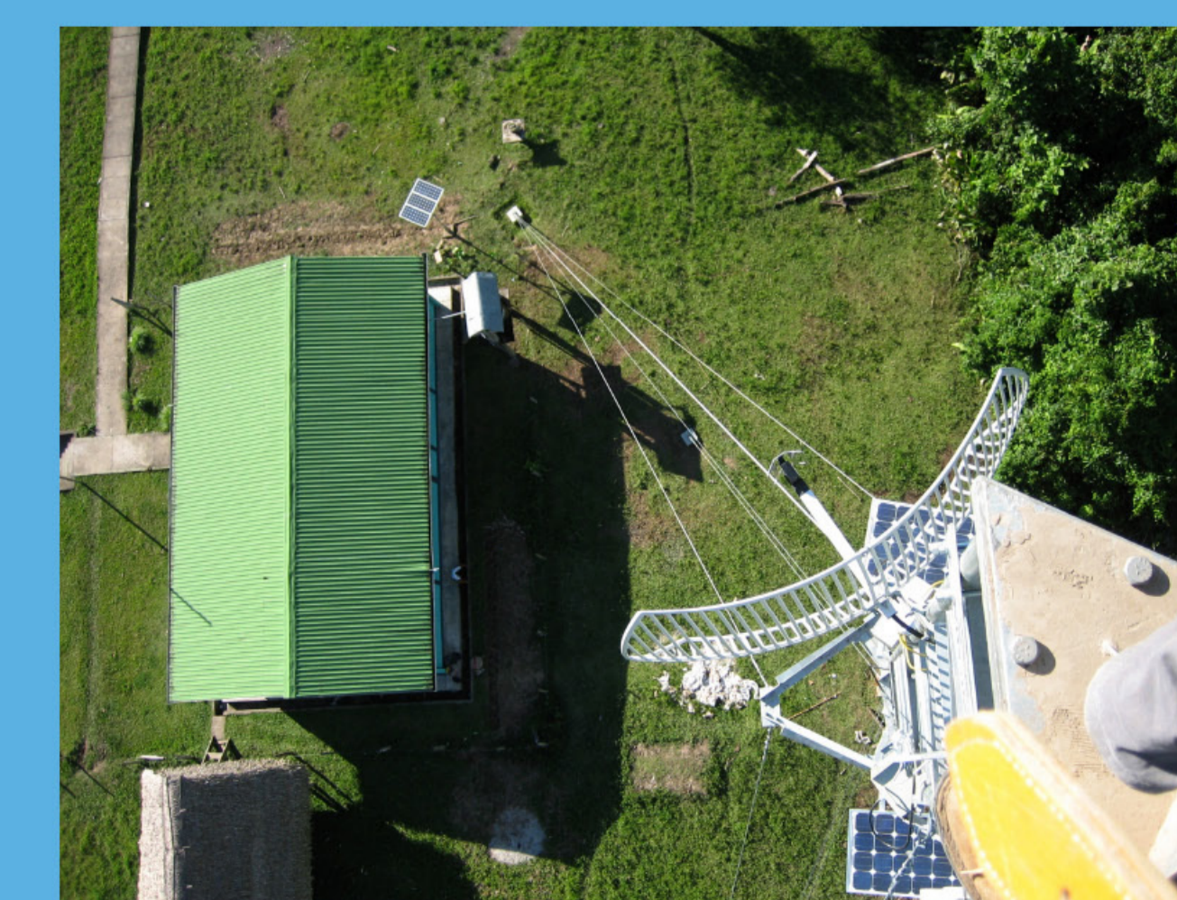
Vista del PS Rumi Tuní desde lo alto de la torre de 90m – Napo – Loreto.
