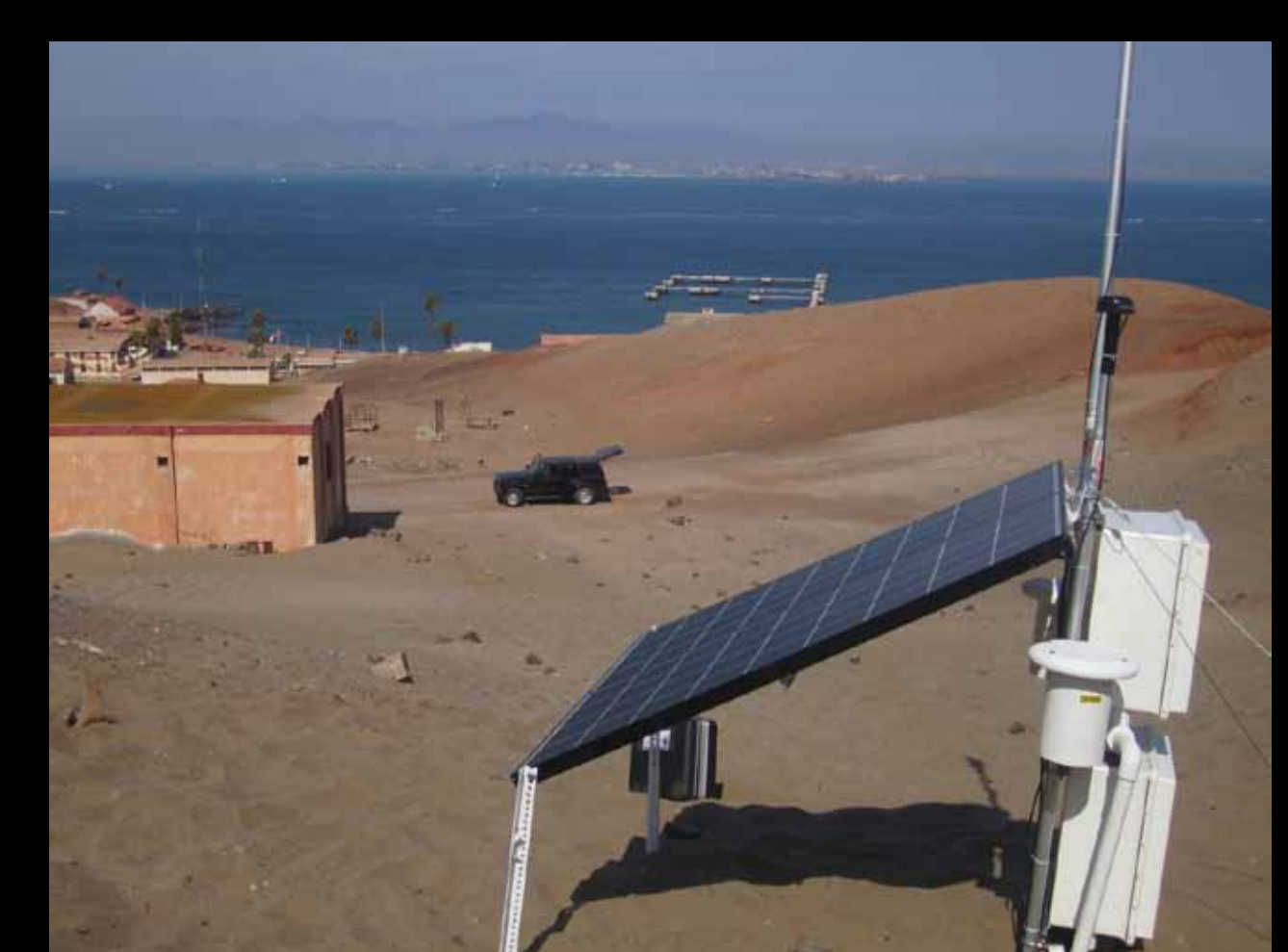
Instalación del magnetómetro en la isla San Lorenzo.
