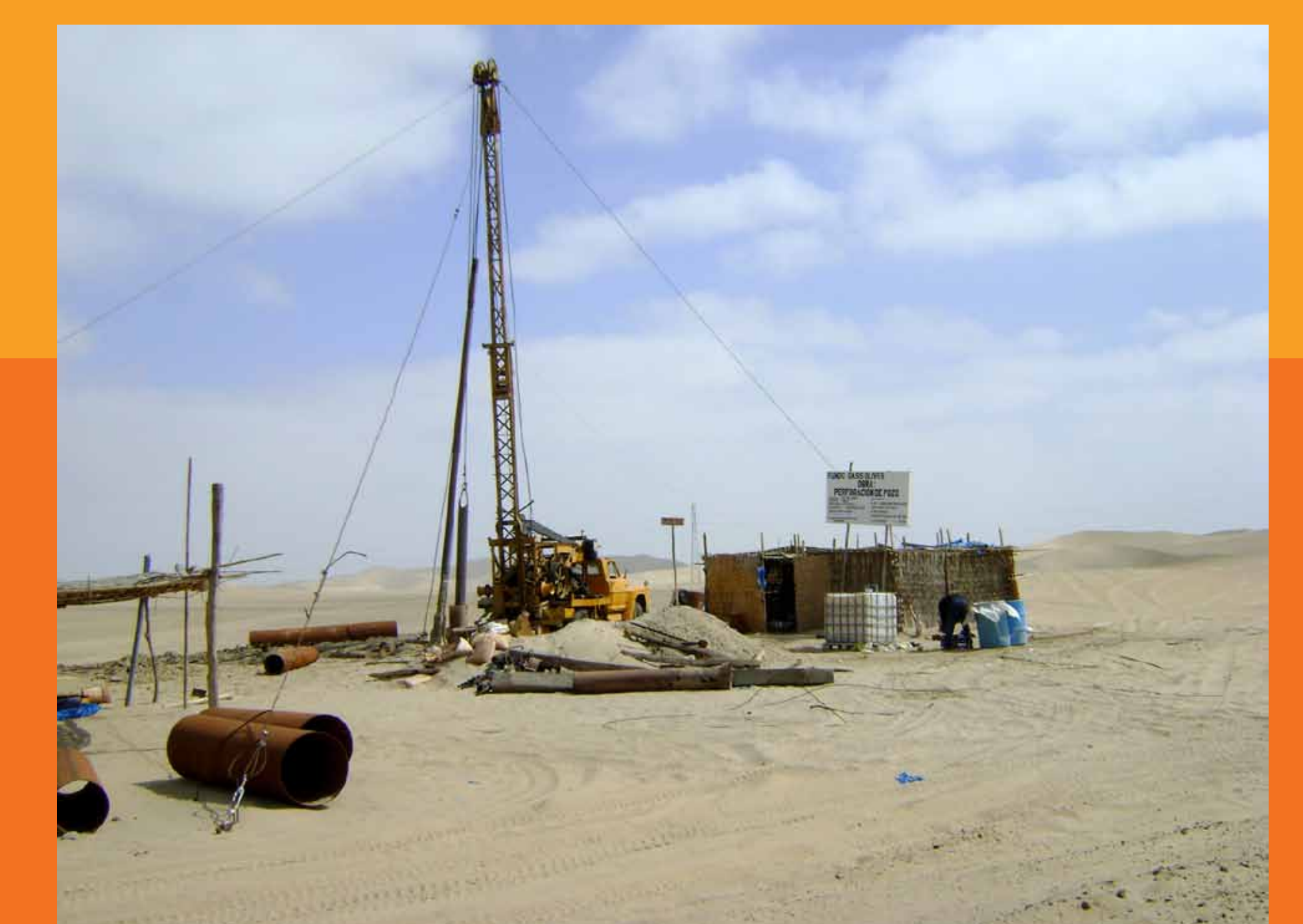
Pozo de agua subterránea en Villacuri, Ica, que utiliza energía eléctrica para su funcionamiento. Fotografía: Ing. Javier Chiong
