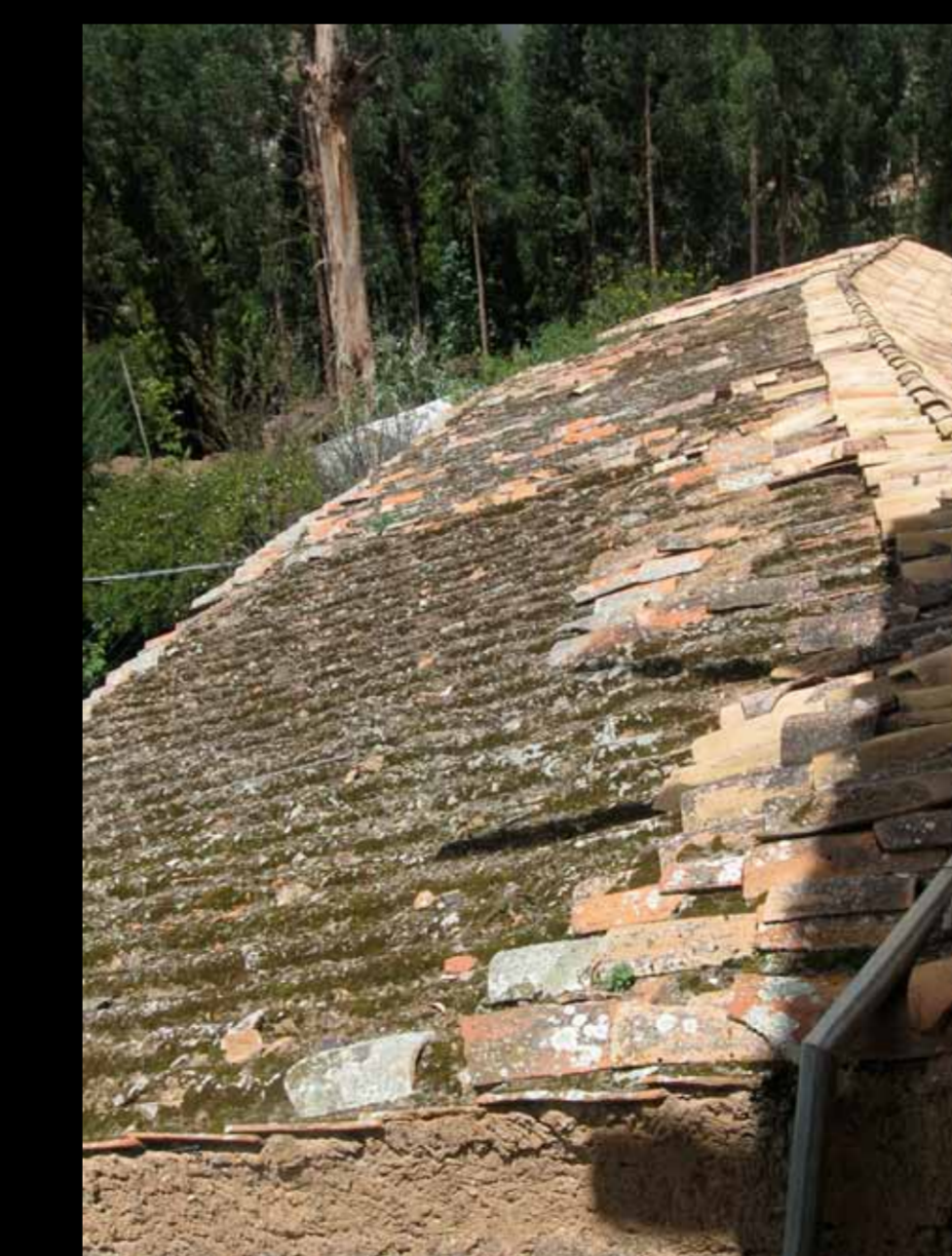
Cobertura de tejas con problemas.
