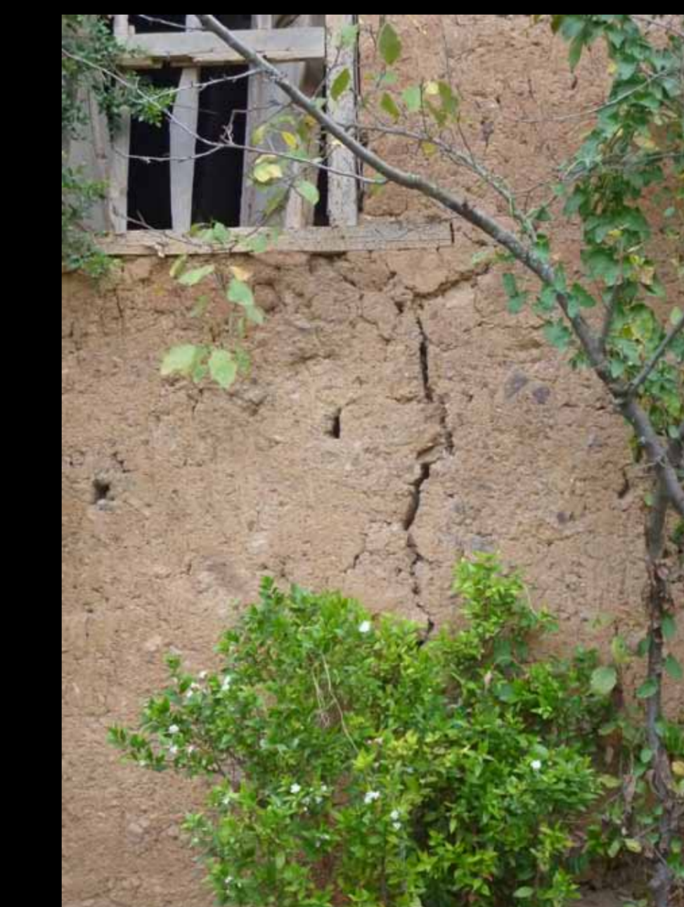
Degradado en tapial.
