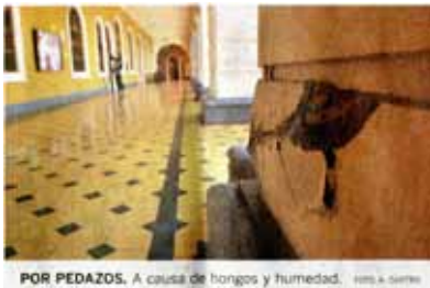
POR PEDAZOS. A causa de hongos y humedad. foto: a. sordo
