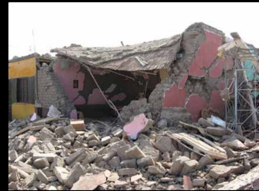
FIGURA 2 Daños en casas de adobe debido a terremotos (Terremoto de Pisco del 2007).
